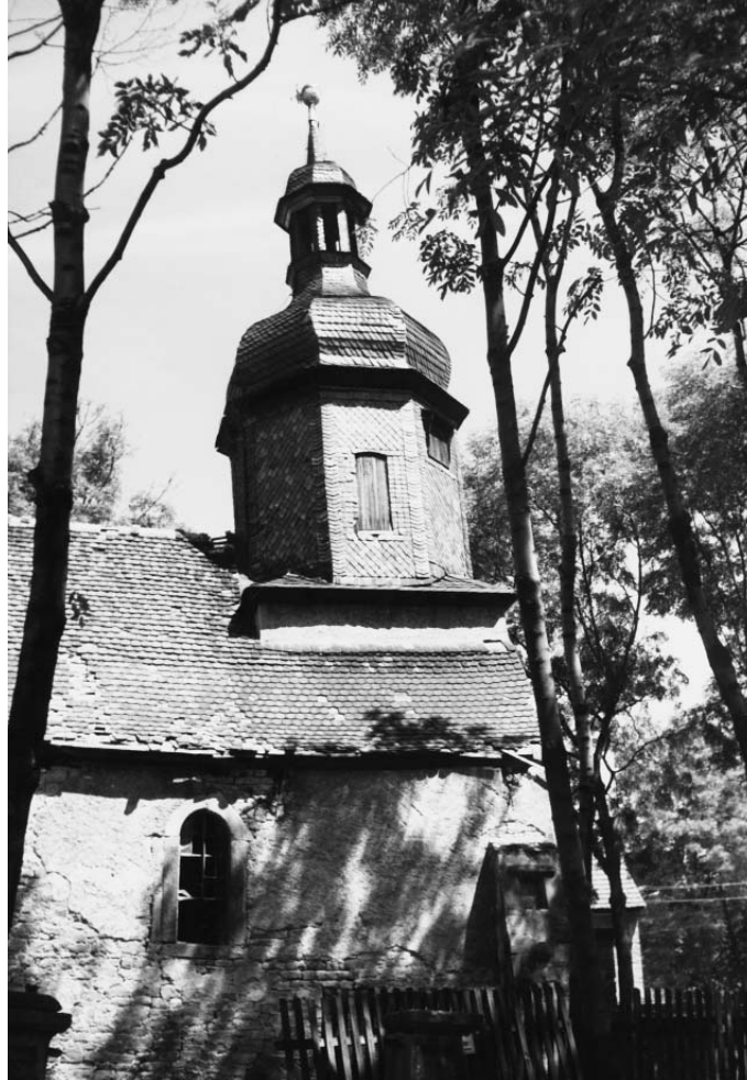
Kirche in Seena: Akute Einsturzgefahr des Daches und Dachstuhles, teilweise schon zerstörte Ausstellung, Sperrung der Kirche wegen Absturzgefahr von Bauteilen
